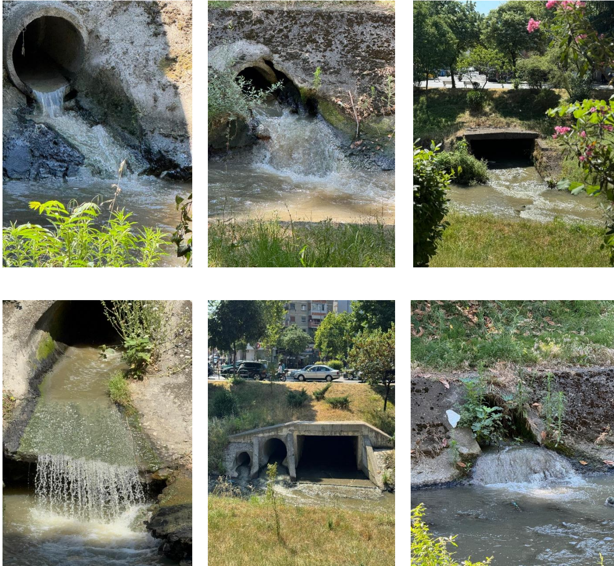
Foto nr. 7-12: Disa nga tubat e shkarkimit të kanalizimeve në lumin e Lanës në Tiranë
