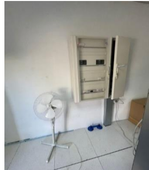
Paneli i kontrollit të energjisë elektrike
