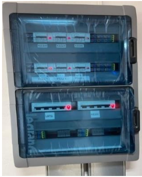
Paneli i kontrollit të energjisë elektrike
